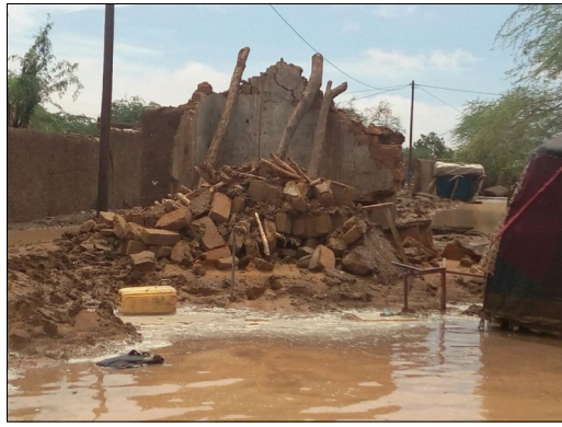
Maison effondrée dans le quartier de l'école TANAT.
